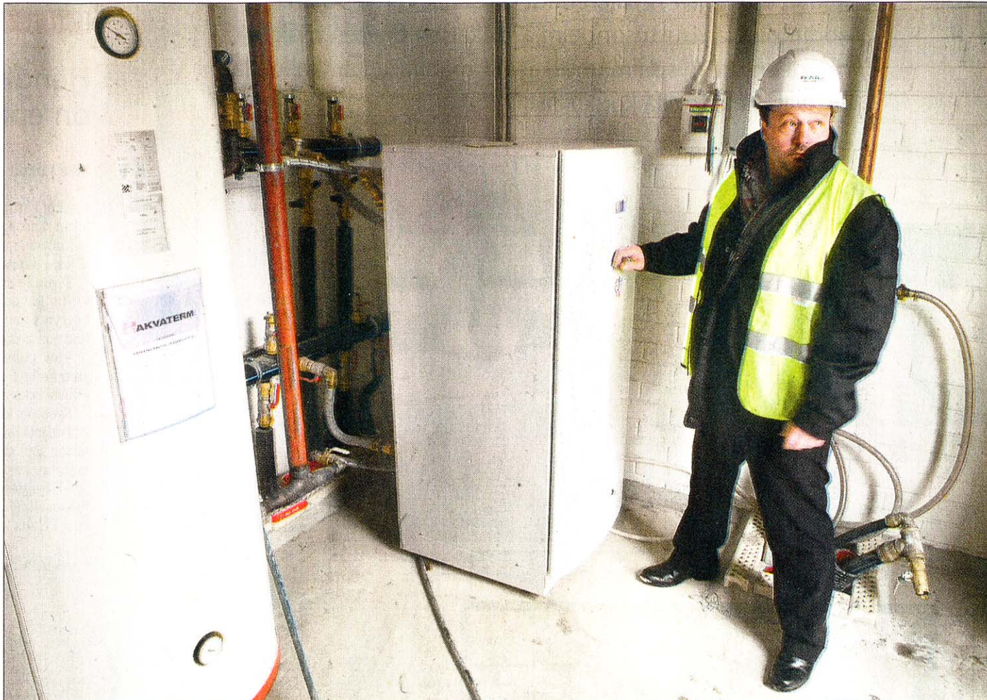
Kerrostalon tekniset tilat eivät paljon tilaa vaadi. Työpäällikkö Ari Pellinen Peab Seicon Oy:stä esittelee pumppua, joka hoitaa koko talon lämmityksen. – Jos tehot eivät jostakin syystä riitä, varajärjestelmänä on sähkövastus, joka takaa, ettei lämpö lopu talosta, Pellinen kertoo.
