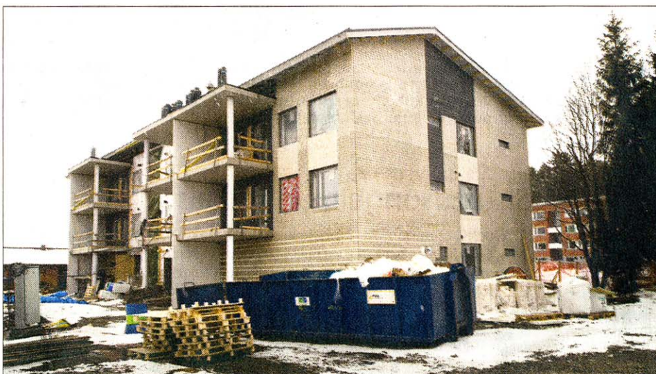
Maskuun valmistuva kolmikerroksinen asuintalo on ensimmäisiä Suomeen rakennettuja maalämpölämmitteisiä kerrostaloja. Kohteessa lämmitys hoituu maalämmöllä, mutta käyttövesi lämpiää sähköllä.
